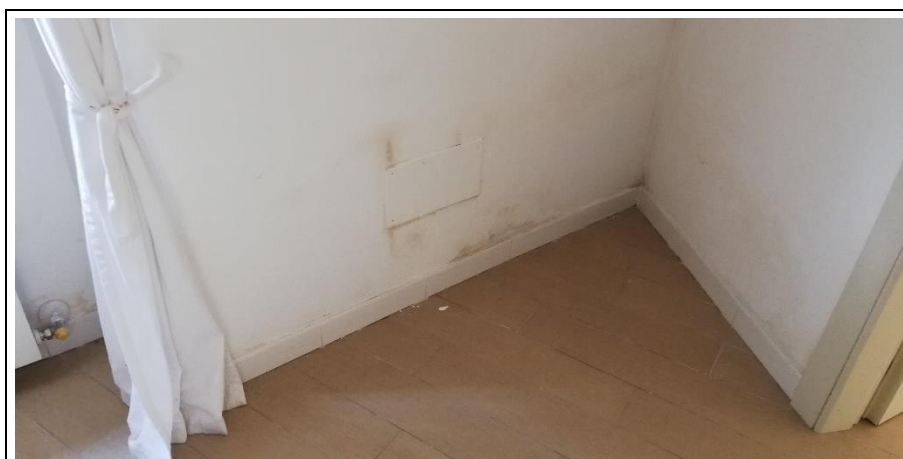
Foto 09 - Degrado dovuto alla risalita capillare
