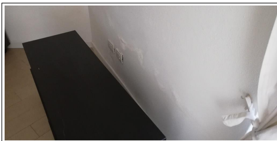
Foto 07 - Degradamento dovuto alla risalita capillare
