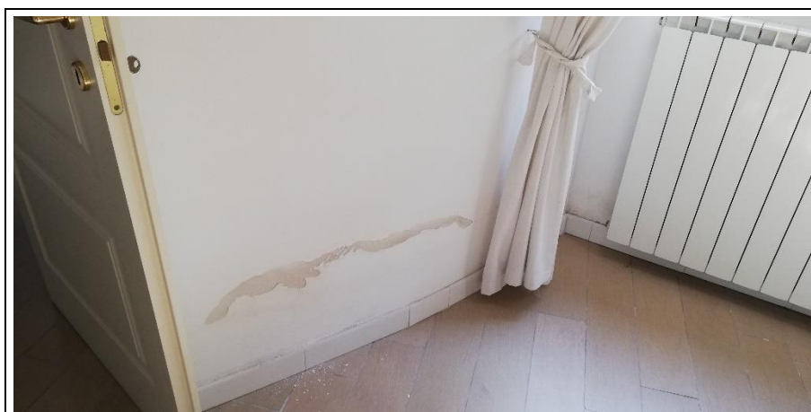
Foto 06 - Degradamento dovuto alla risalita capillare
