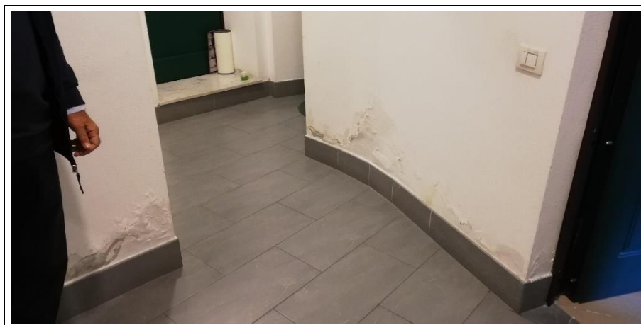
Foto 05 - Degradato dovuto alla risalita capillare
