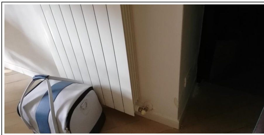
Foto 10 - Degrado dovuto alla risalita capillare
