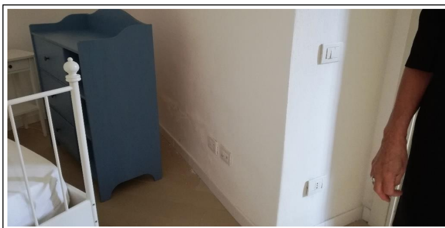
Foto 11 - Degrado dovuto alla risalita capillare
