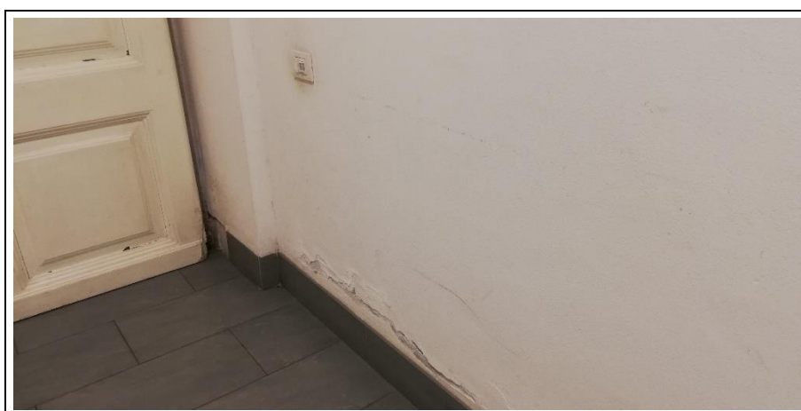
Foto 04 - Degradato dovuto alla risalita capillare
